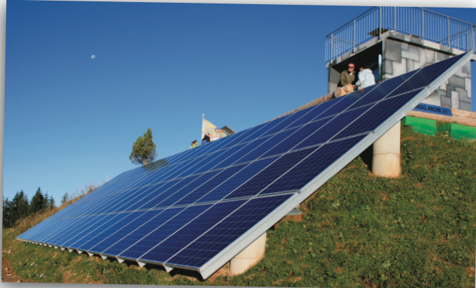
Die Photovoltaik-Anlage auf Rigi-Scheidegg: die Königin des Berges. Die ideale Lage sorgt dafür, dass der Ertrag rund 25% über dem einer vergleichbaren Anlage im Flachland liegt – und auch im Winter eine hohe Leistung generiert wird.
