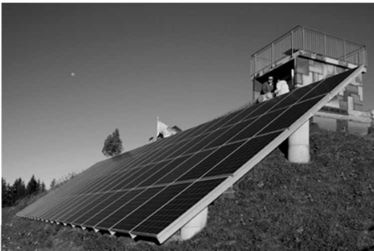
Effizienz und Ästhetik: Die Solaranlage auf der Rigi Scheidegg bei der Einweihung am 15. Oktober 2011. 132 Quadratmeter gross und jährlich rund 22'200 kWh stark.
